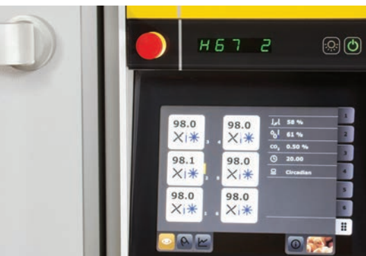
Controle modular das máquinas
